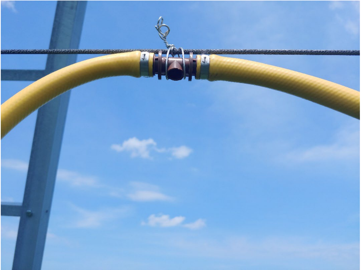
Figure 24. Bris mécanique du T à insertion dû au maintien des tubes g-à-g au sol par le gel.
