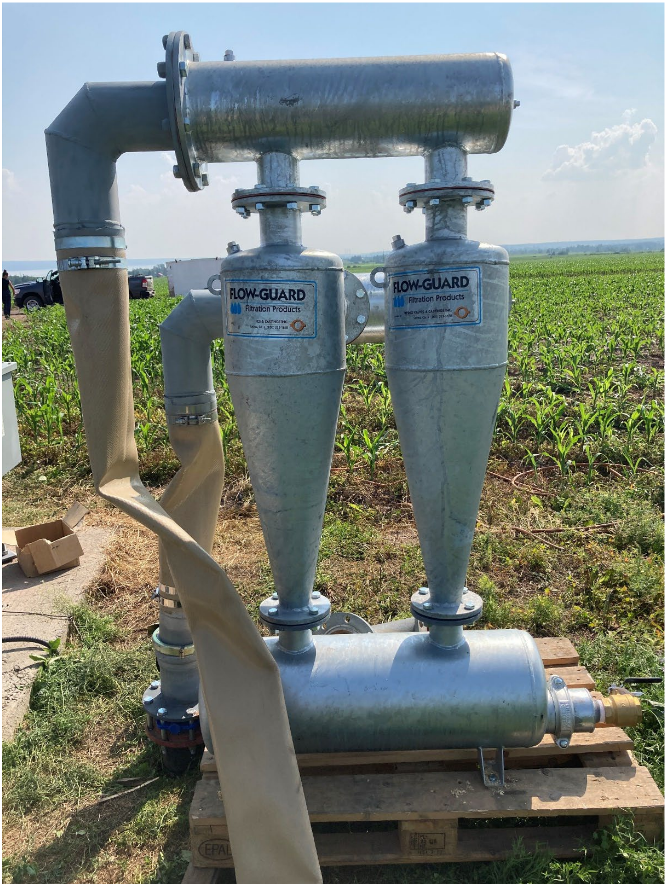
Figure 21. Système cyclonique de prétraitement de l'eau (séparateur de sable).
