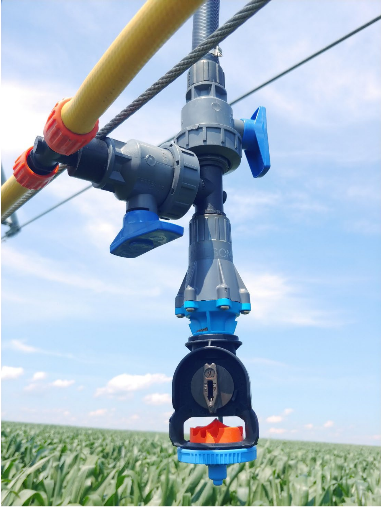
Figure 19. Montage de système hybride sur les pendillards du pivot (tuyau noir), T à compression sur la ligne d'eau secondaire.
